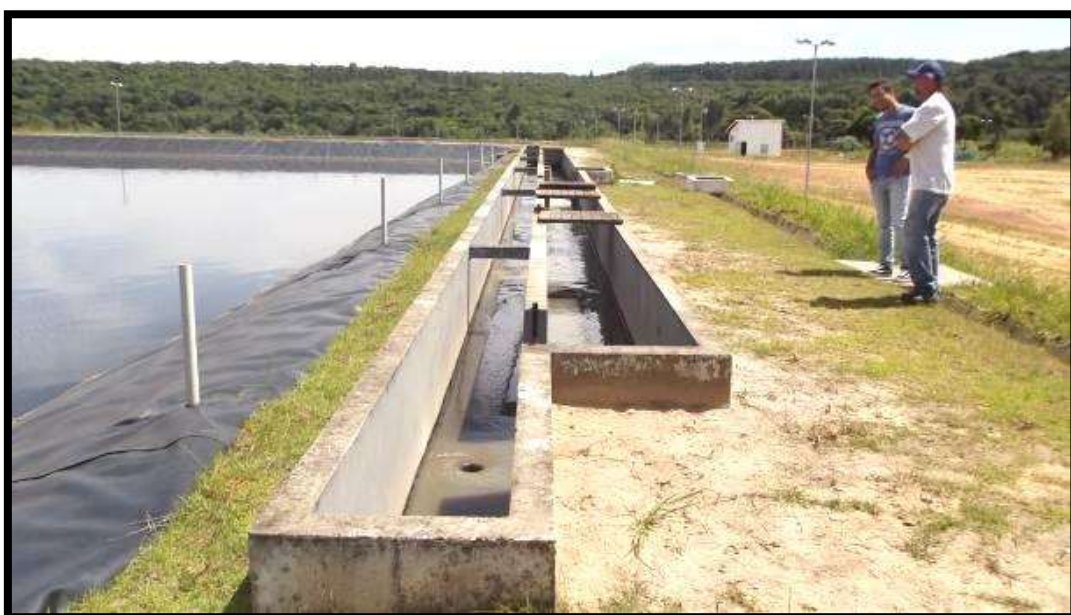
Figura 25 - Canaleta de distribuição da Lagoa Anaeróbia
