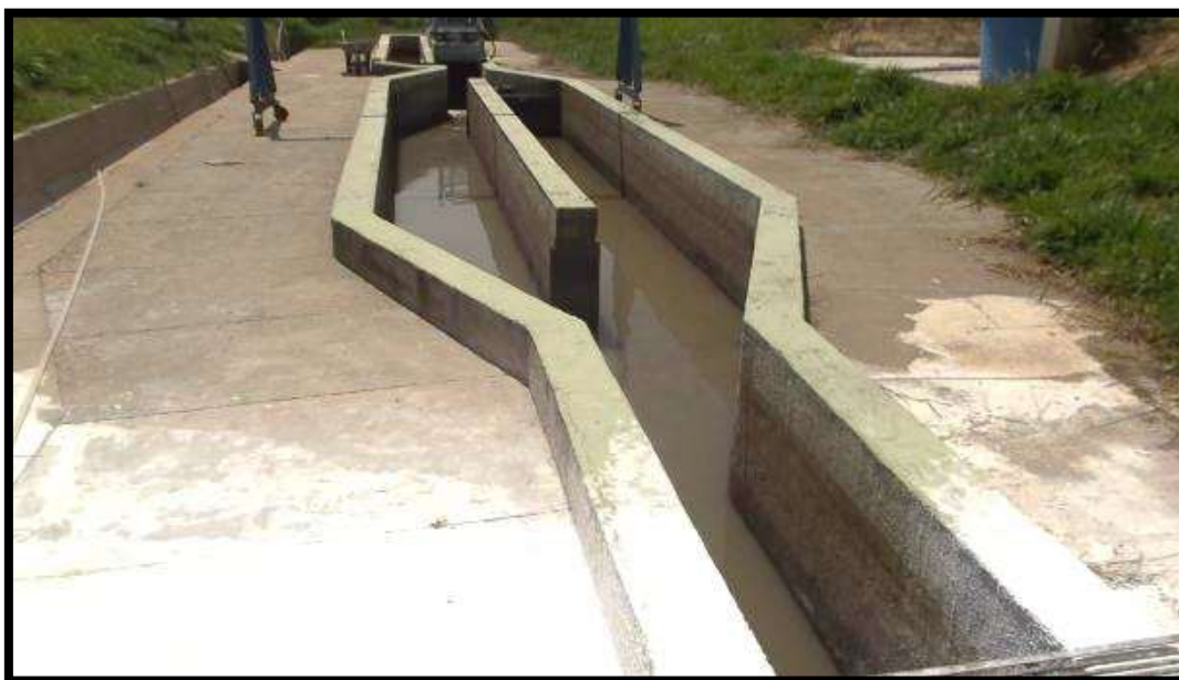
Figura 23 - Tratamentos Preliminares na ETE
