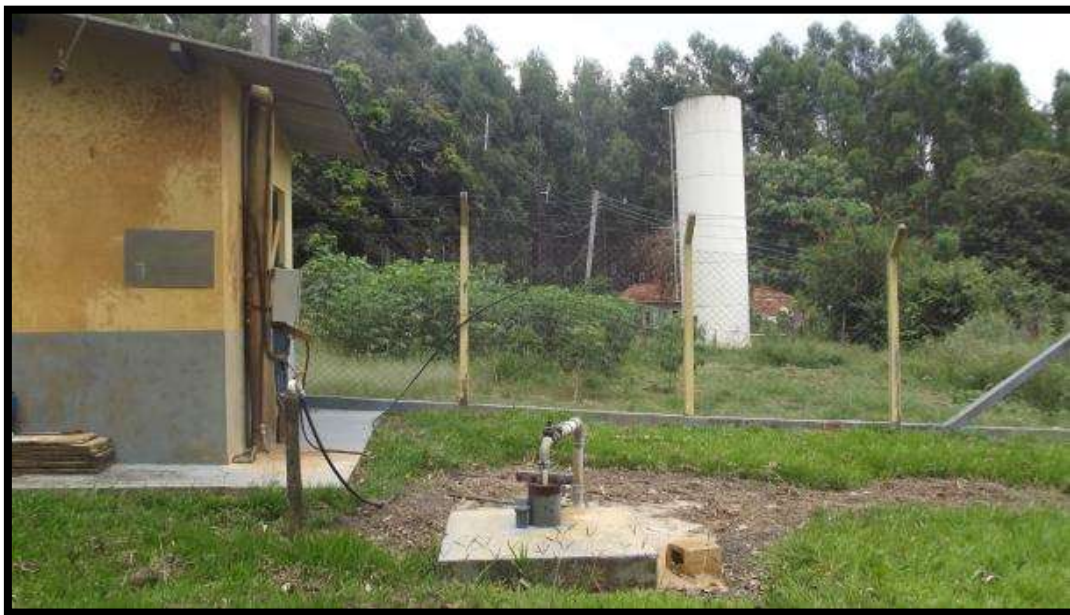
Figura 8 - Poço 07 e Reservatório 08 – Rua 02 Itaqueri da Serra
