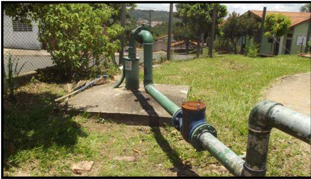
Figura 10 - Poço 9, Reservatório 2 – Enterrado, Rua Cataguazes
