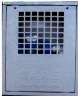
Caixa de Proteção do Hidrômetro
