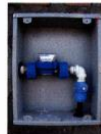
Peças instaladas na Caixa de Proteção
